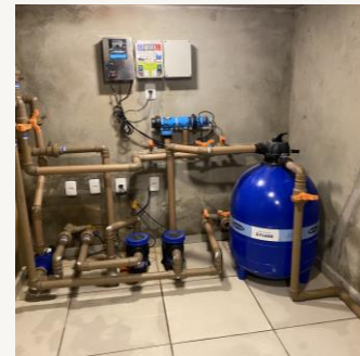
AQUECIMENTO DA PISCINA
